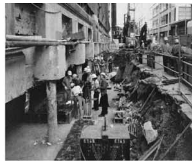
【写真⑤旧市庁舎外壁の実施工状況 壁・柱が浮いた状態】
